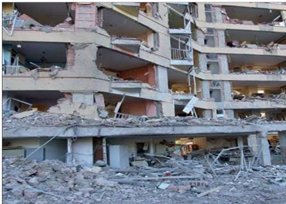
Рис. 4. Конструкція, пошкоджена вибухом.
