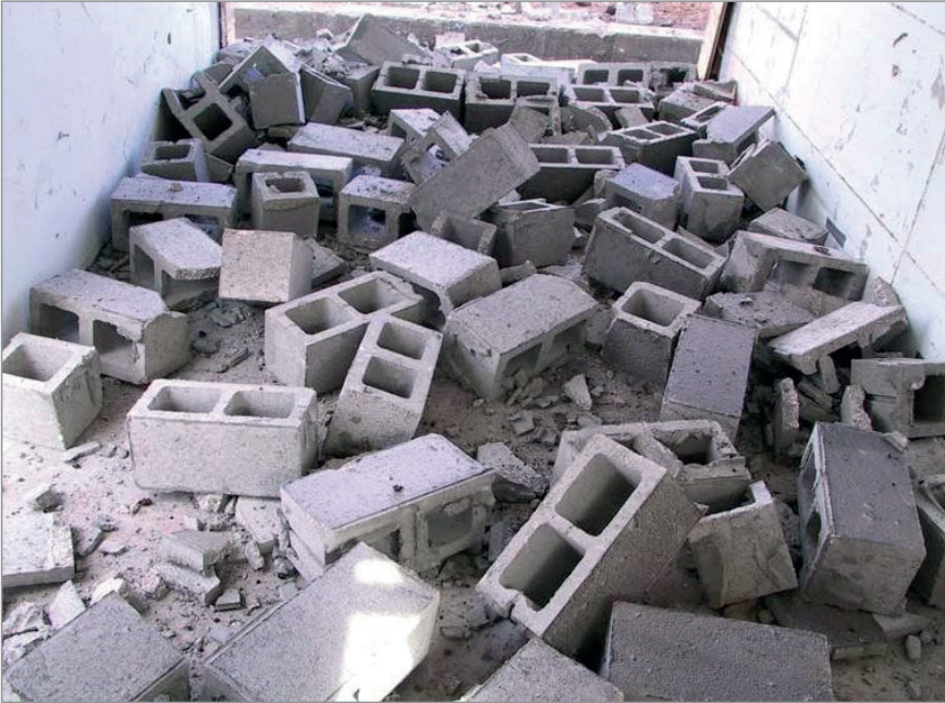
Рис. 5. Приклад руйнації житлового будинку без захисних покриттів.
